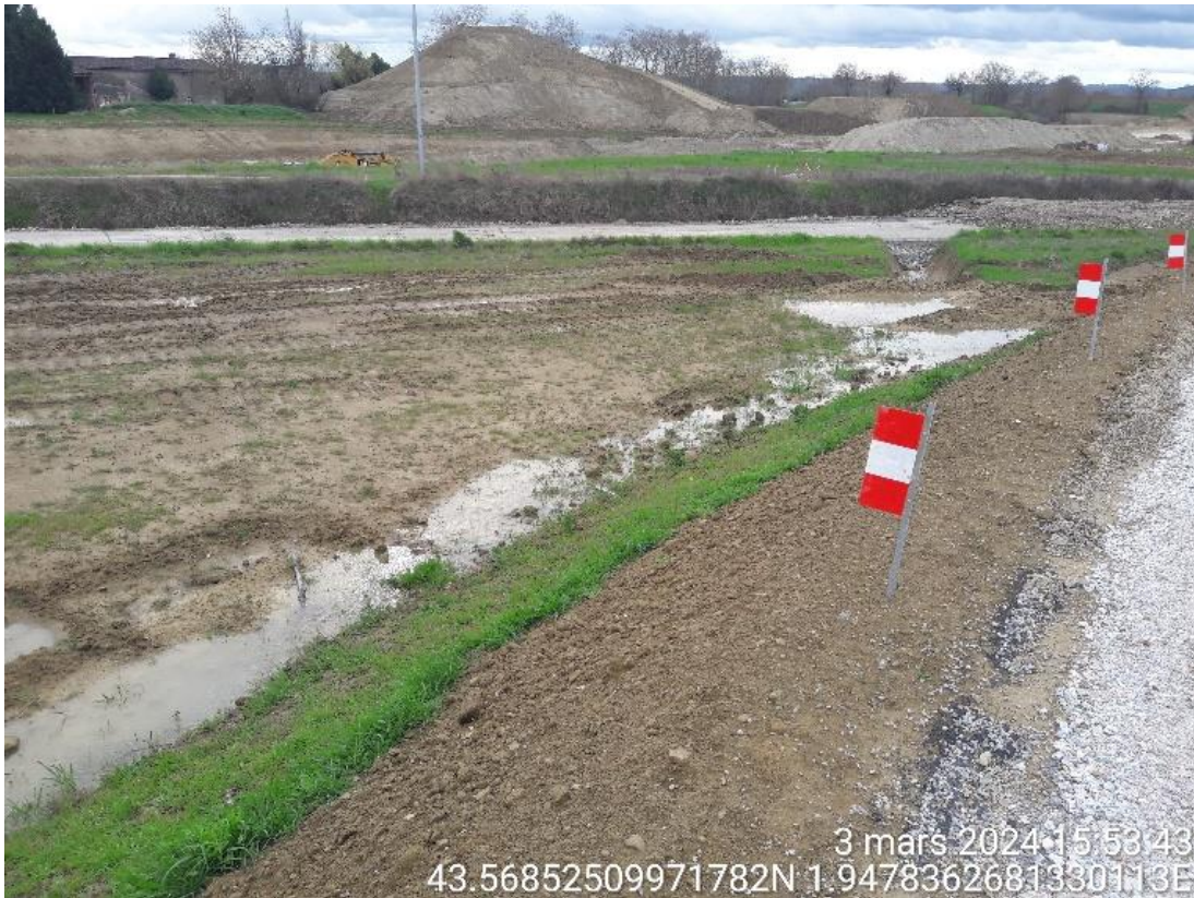
Figure 93: Exutoire du BP36300 directement sur la zone de chantier – APELLE (81)
