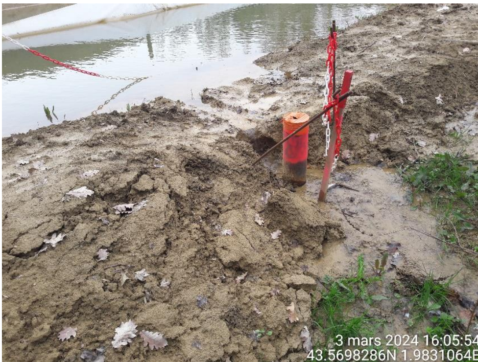
Figure 89: Débordement du BP37450 - Réalisation non conforme du bassin – PUYLAURENS (81)
