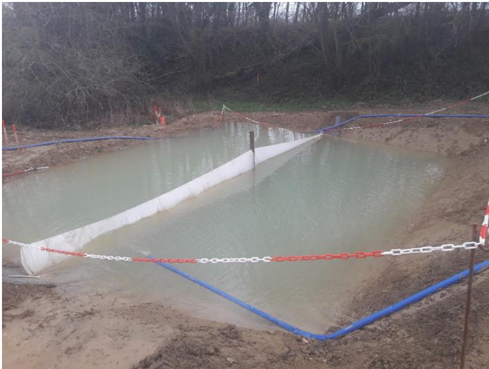
Figure 88: Refoulement de l'eau souterraine vers BP37450 eaux pluviales PUYLAURENS (81) 10/02/2024
