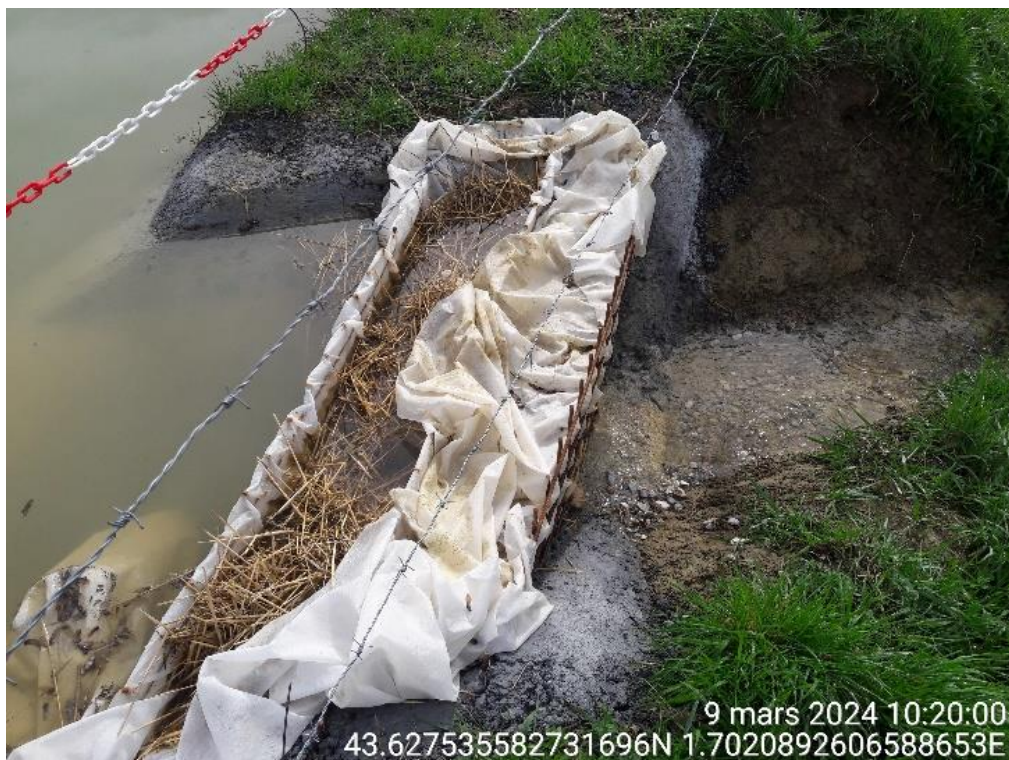
Figure 29 : BP15300S TEULAT (81) Filtre à paille avant filtre à gravier -
