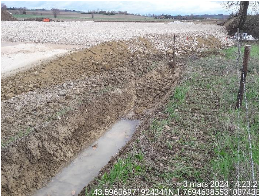
Figure 79: PI2118 - VENDINE (31) - Pente dans le mauvais sens
