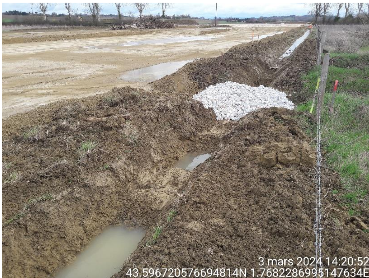
Figure 80: PI2118 VENDINE (31) - Tas de cailloux pour « traiter » les eaux pluviales avant rejet dans le milieu naturel.
