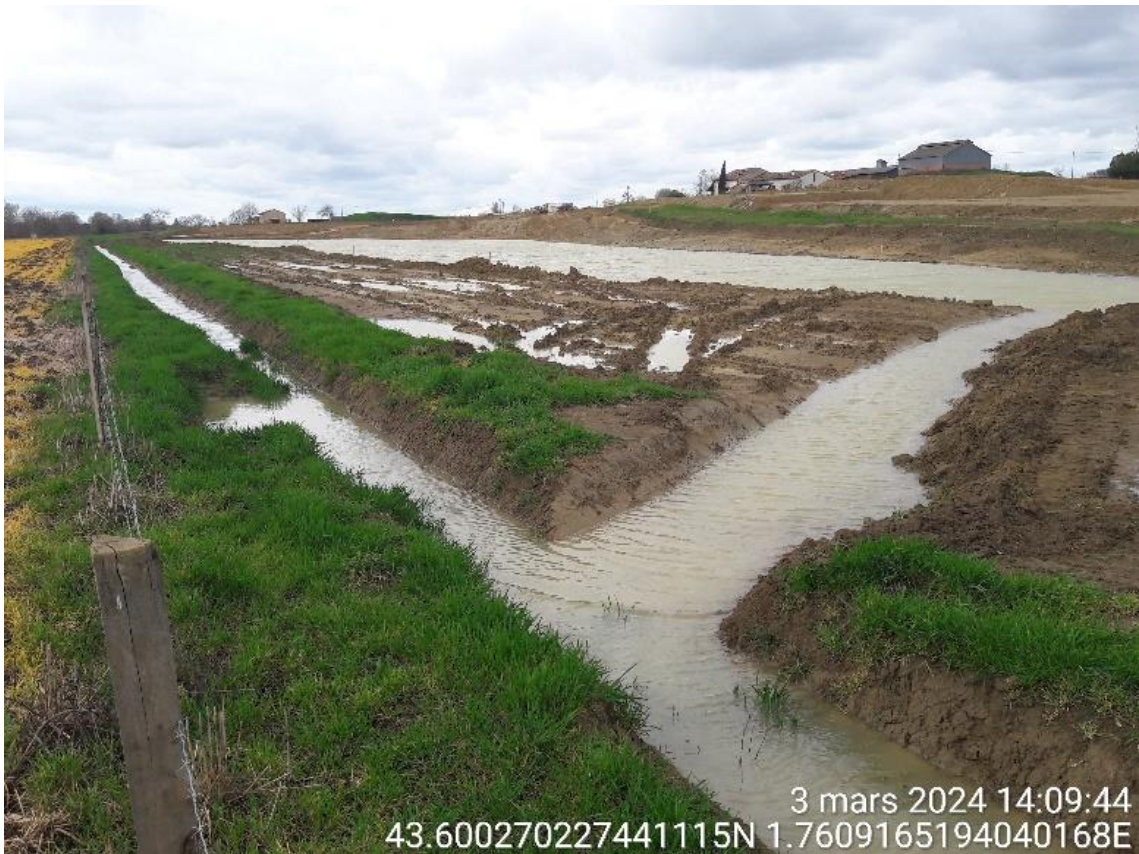
Figure 52: Eau de la nappe mise à l'air libre (haut) relié au fossé de collecte des eaux pluviales (bas) - FRANCARVILLE (31)
