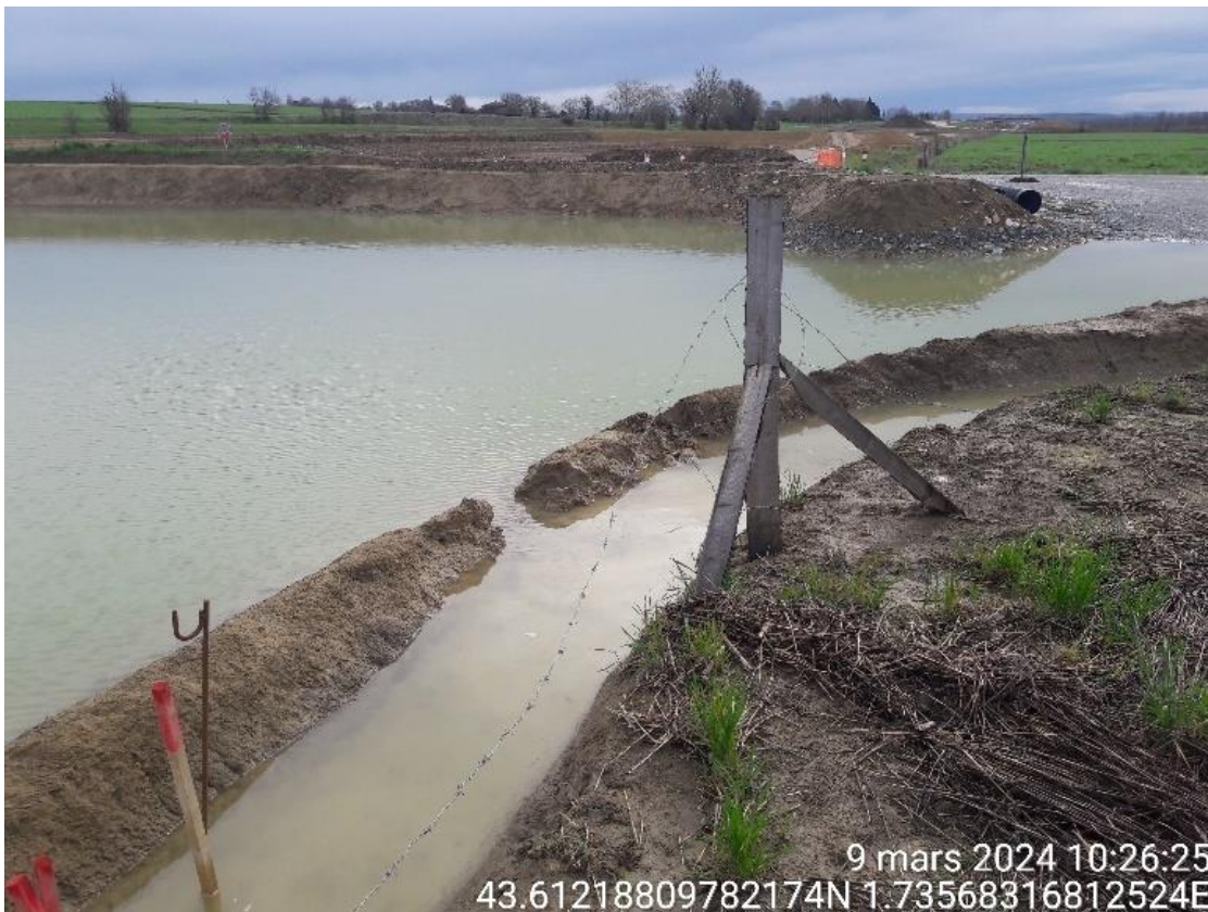
Figure 58: Le fossé (à droite) achemine l'eau polluée vers un BP, en contact avec l'eau de la nappe (à gauche). MONTCABRIER (81)
