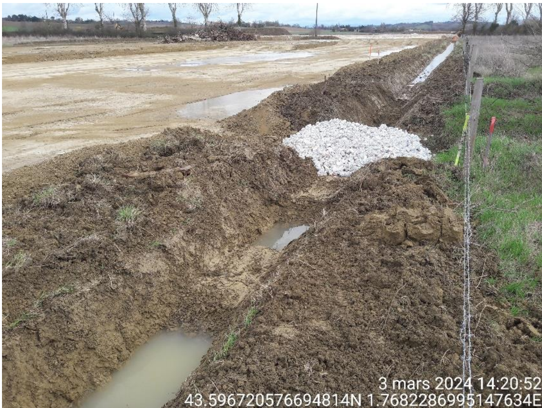
Figure 15 : Fossé sans bassin, juste un tas de gravier – CAMBON (81)
