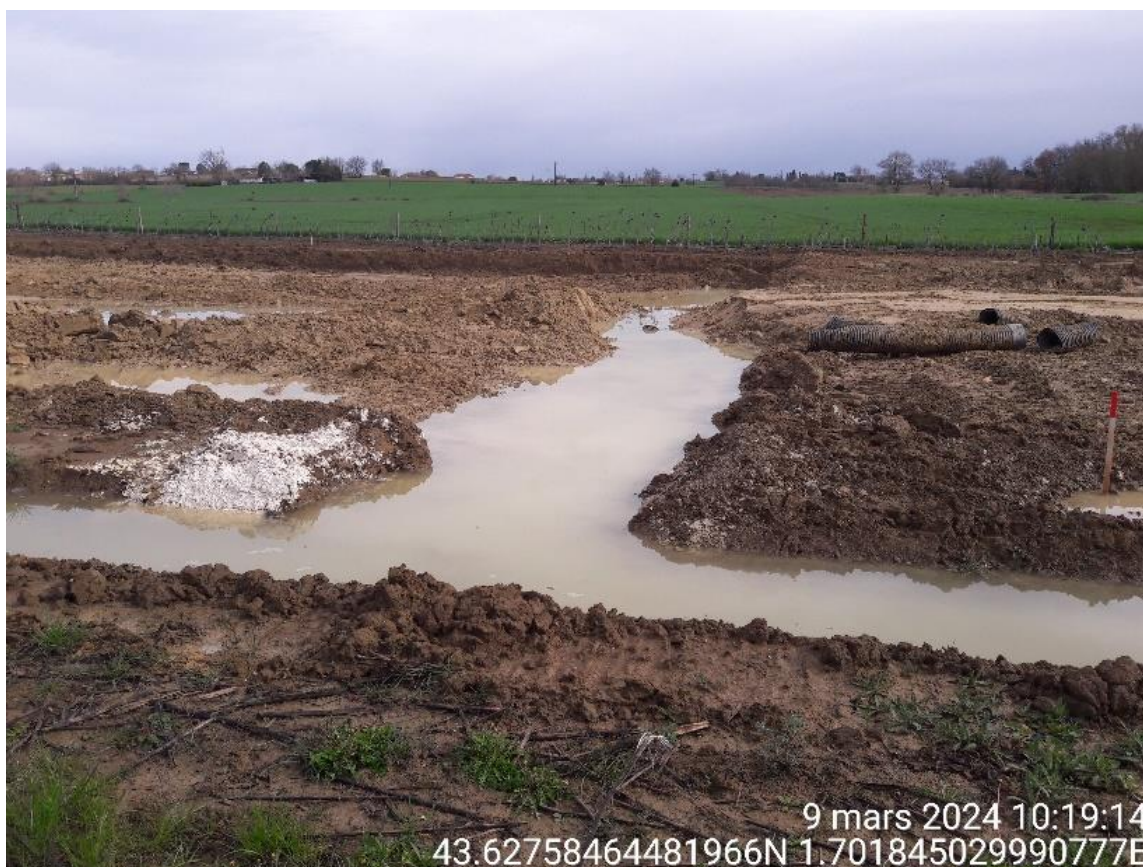
Figure 54 : BP15300S TEULAT (81) avec tas de chaux à gauche
