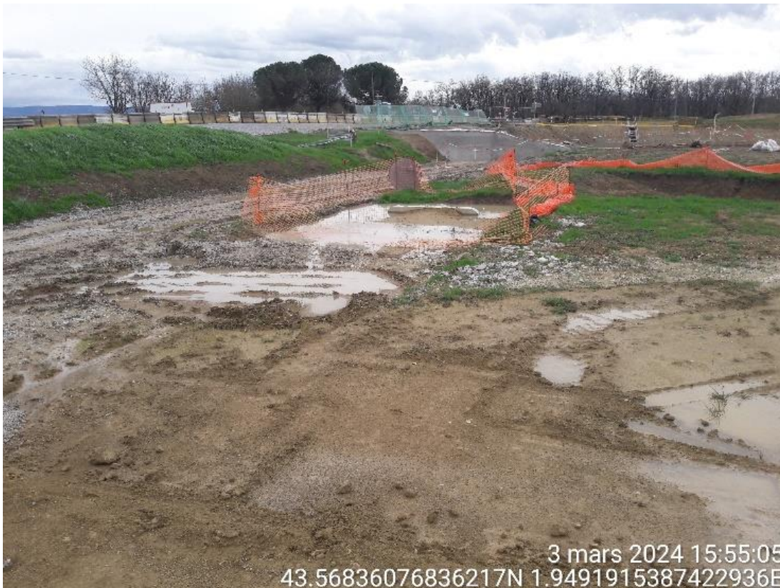
Figure 94: OH non indiqué sur les plans et totalement immergé (aval) – APELLE (81)
