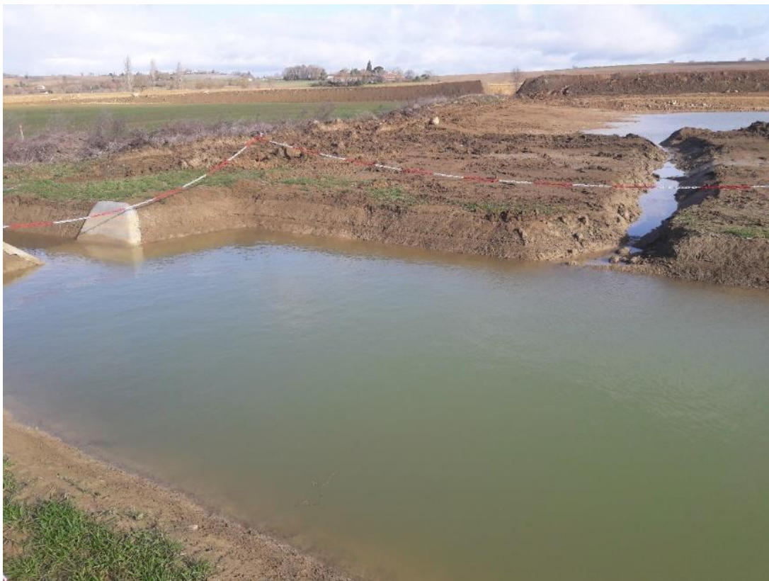
Figure 59: BP 19xxx FRANCARVILLE (31) le 11/02/2024. Fossé creusé (en haut à droite) pour évacuer l'eau de la zone de chantier, mais le fossé n'est pas raccordé du bon côté du bassin. Il est raccordé au 2 e compartiment. Point GPS: 43.602584, 1.752358
