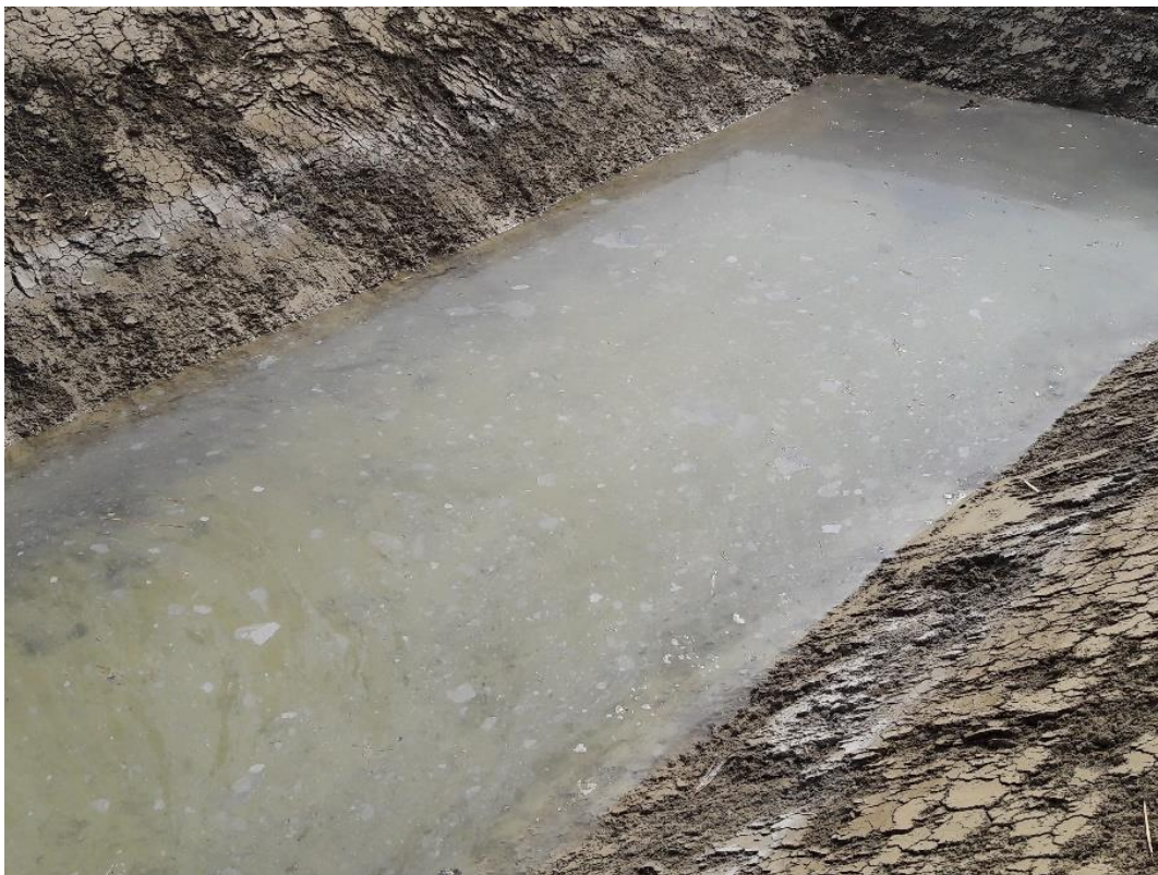
Figure 44 : BP20450 VENDINE (31) le 21/07/2023 - Point GPS : 43.599901, 1.762760 - Pollution laitance béton dans nappe mise à l'air libre
