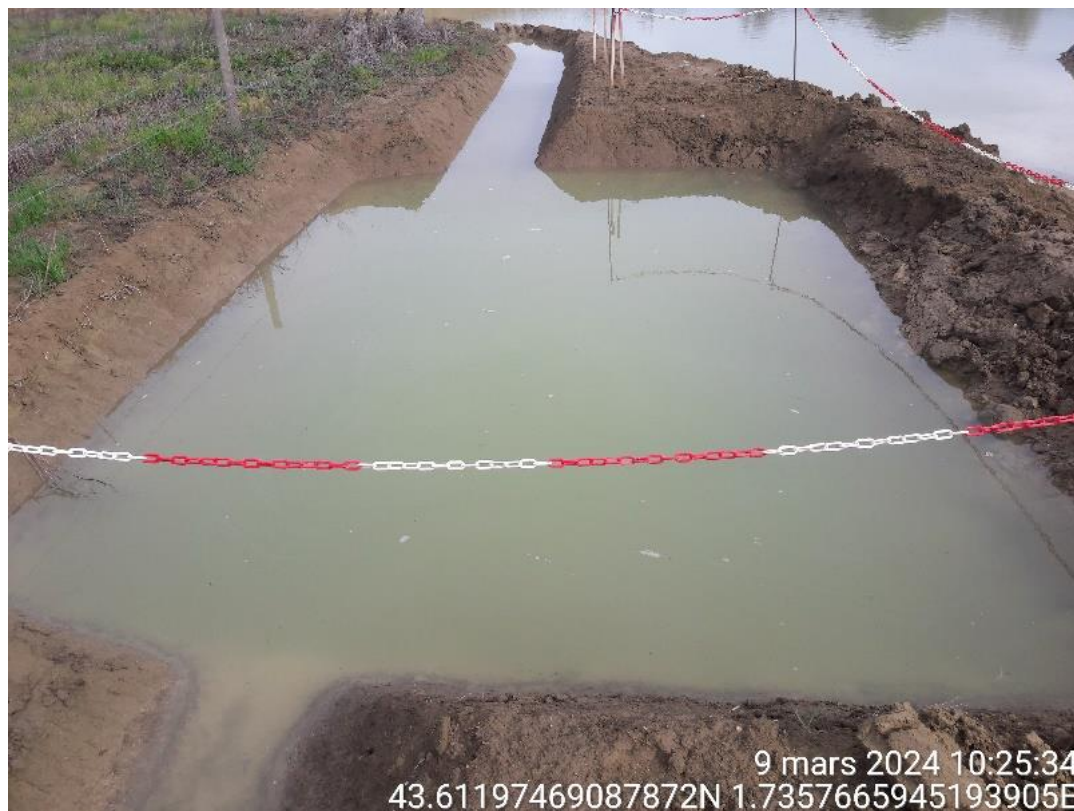
Figure 67: Bassin non-équipé et mal dimensionné pour évacuer l'eau souterraine mise à l'air libre - MONTCABRIER (81)
