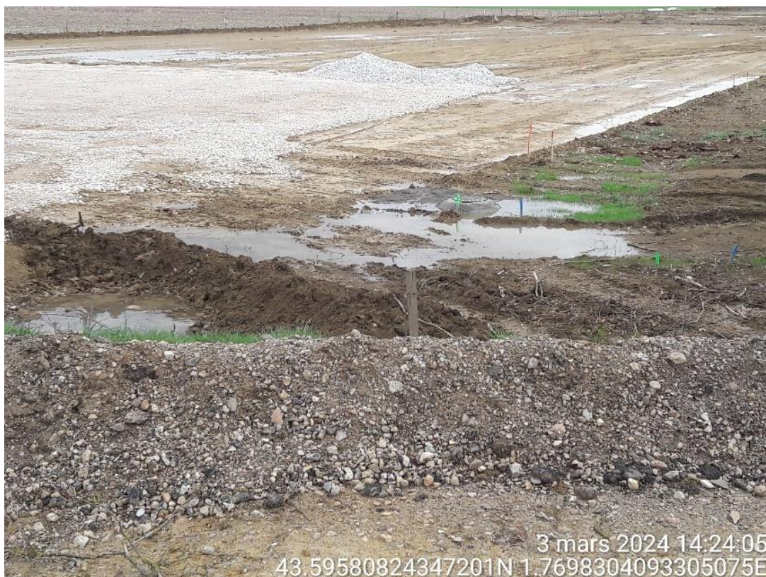
Figure 77: PI2118 VENDINE (31) – La nappe remonte sur les côtés de la plateforme
