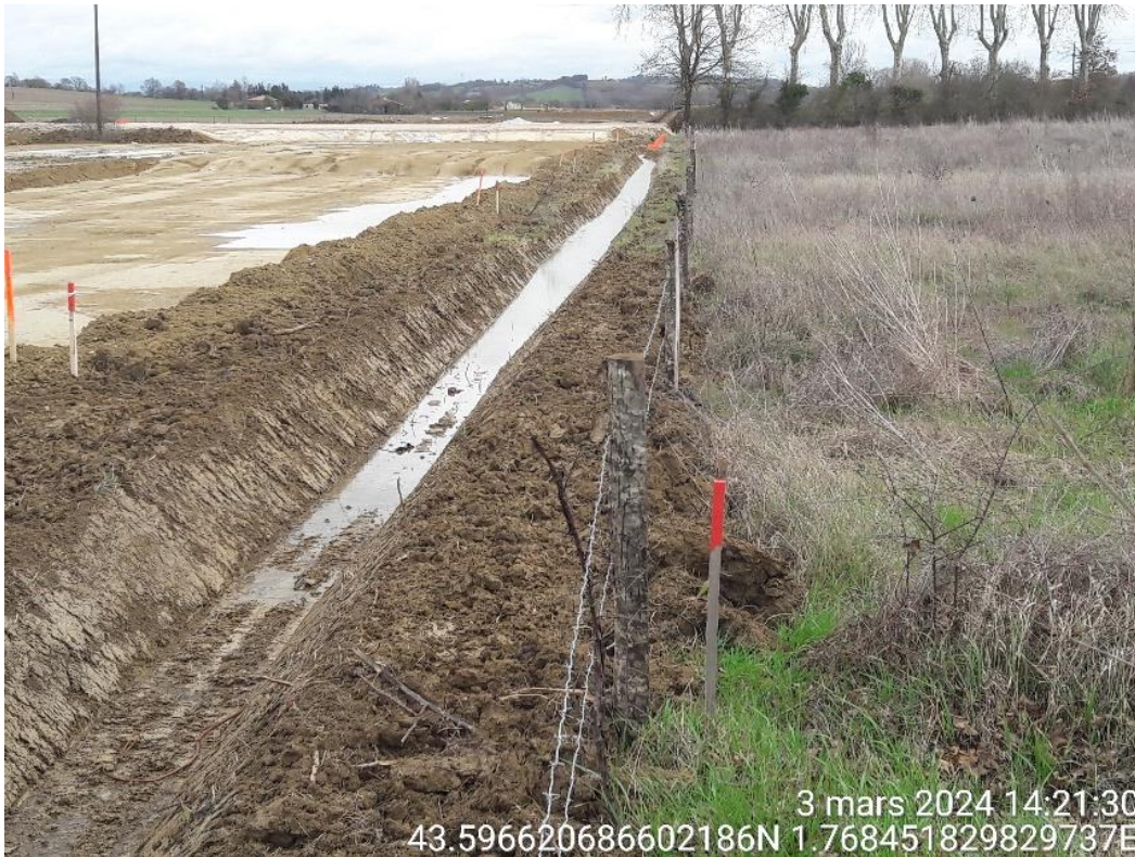
Figure 78: La nappe remonte dans les fossés de collecte des eaux pluviales - VENDINE (31)
