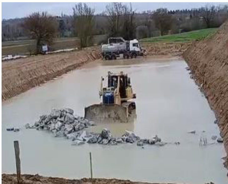
A VILLENEUVE-LES-LAVOUR (81), Engin travaillant dans l'eau souterraine mise à l'air libre. En arrière-plan camion-citerne en train de pomper l'eau de nappe mise à nue par l'excavation
